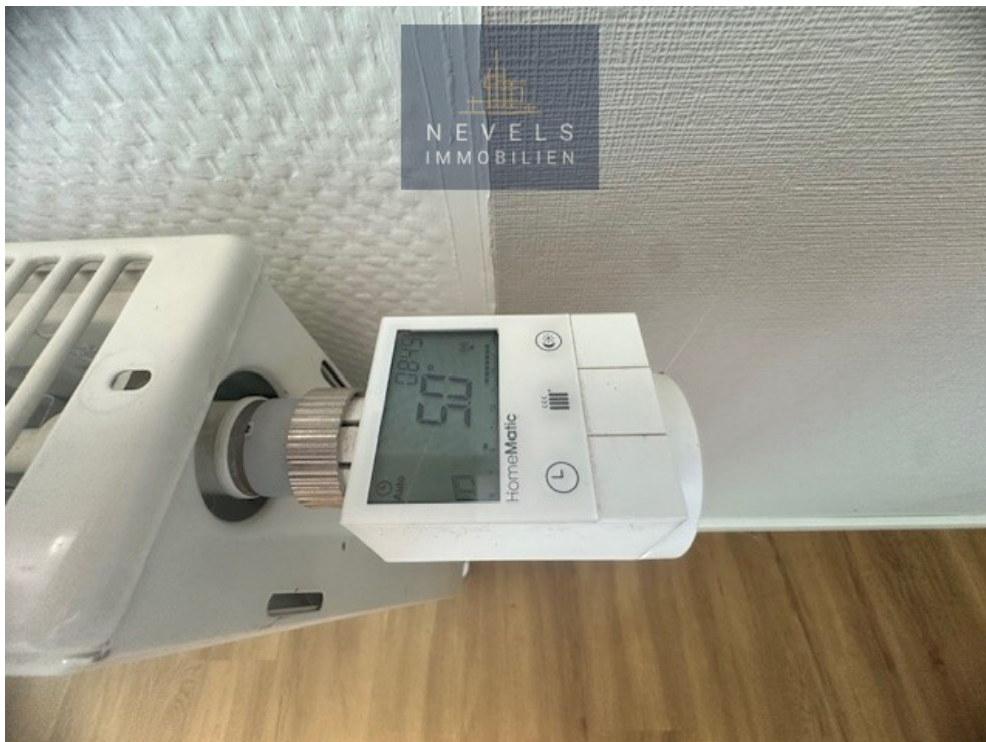
Elektronische Thermostate im Erdgeschoss
